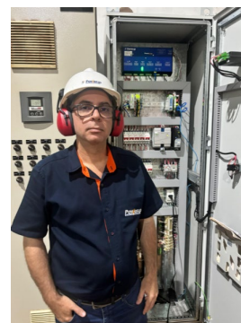
Interior do novo painel, com montagem e cabeamento organizados
